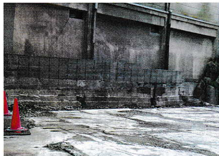
納骨堂裏側の沈下部分のひび割れ
